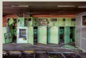
Cuadros eléctricos de tensión.
