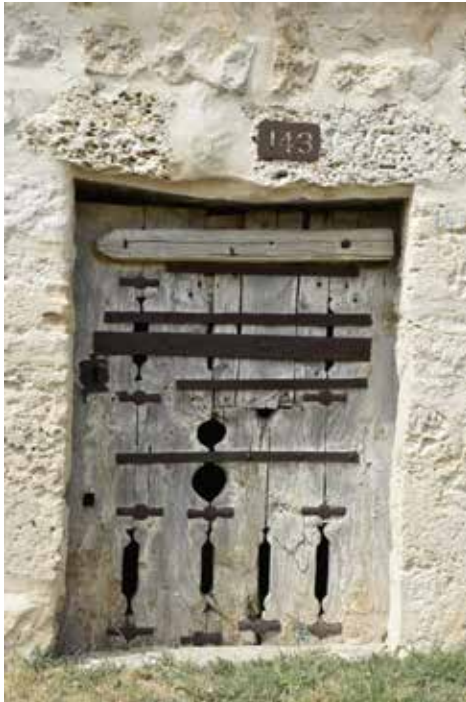
Puerta de rejilla.
